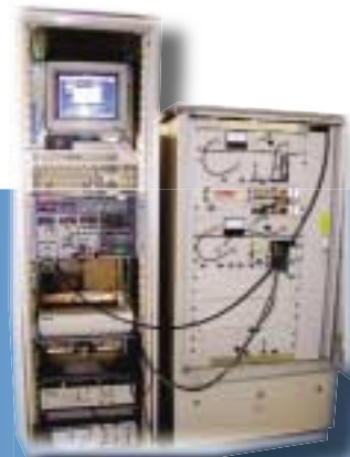
Endabnahme eines Funkschranks
