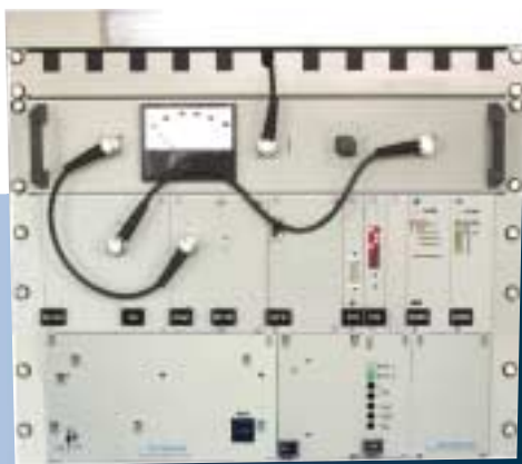
FSO mit Ladegerät und Schaltmessfeld
