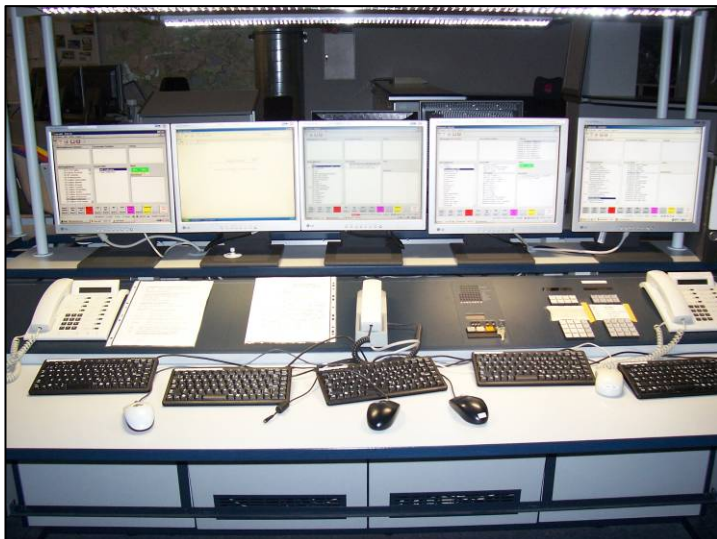
Arbeitsplatz Digitale Alarmierung (manuelle Alarmierung)
