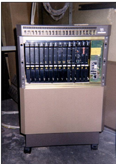
1992 Telefonanlage Typ SEL 5625
